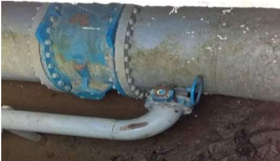
Photo n°03 : Chambre de contrôle du débit (©Amraoui et Ogab ,2022)
