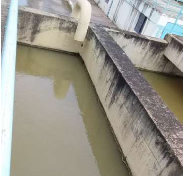
Photo n°09 : Chambre coagulation/ recyclage des boues de mélange (©Amraoui et Ogab ,2022)
