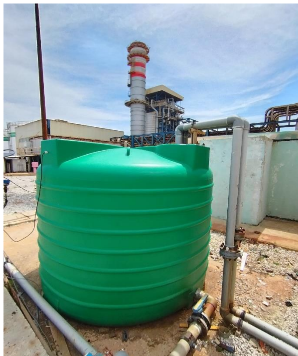
Figure A.1. Réservoir de stockage de l'eau osmosée
