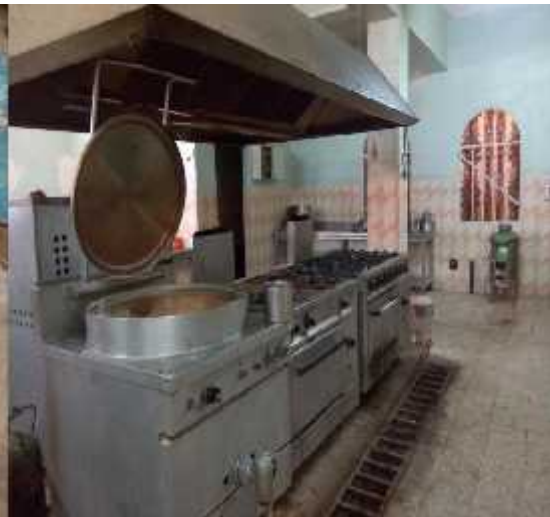
Photo n° 14: Batterie de la cuisine. (Mezouar, 2017)
