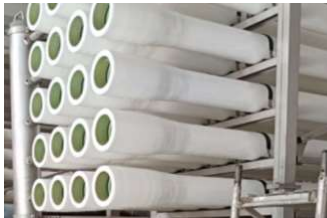
Figure III.8 : Modules de membranes d'osmose inverse.
