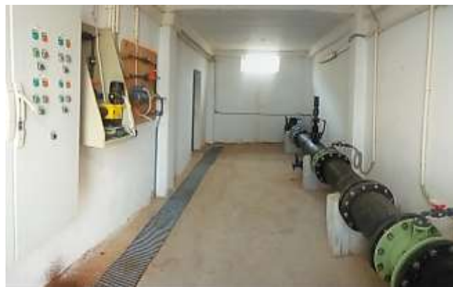
Figure III.4 : Chambre des vannes de la station.
