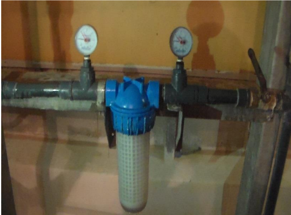
Figure 7- Filtrage de l'eau au niveau du bâtiment (Chekkal Met Amara Z. Année 2020/2021)
