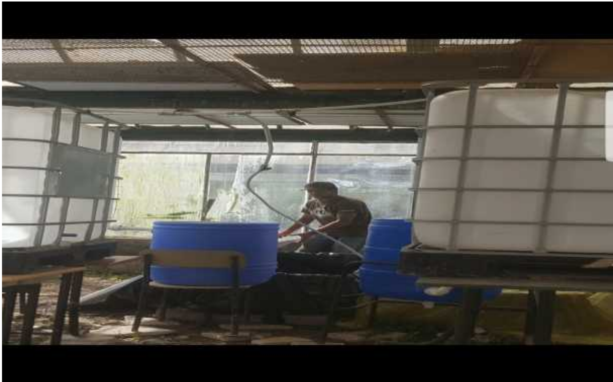
Figure 37 : Tuyauterie du puisard au bac à poissons
