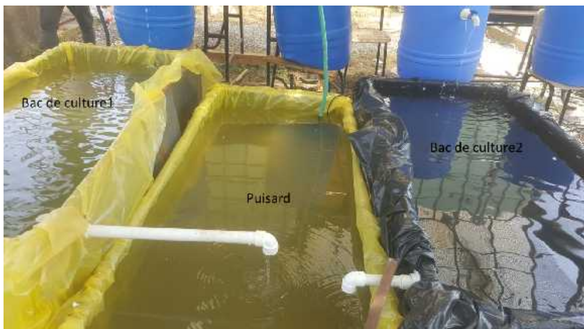
Figure 36 : Tuyauterie des lits de culture au puisard
