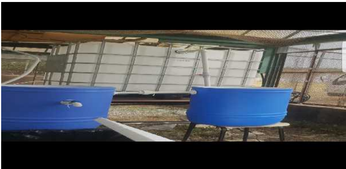
Figure 38 : Tuyauterie du bac à poissons aux filtres mécanique et biologique
