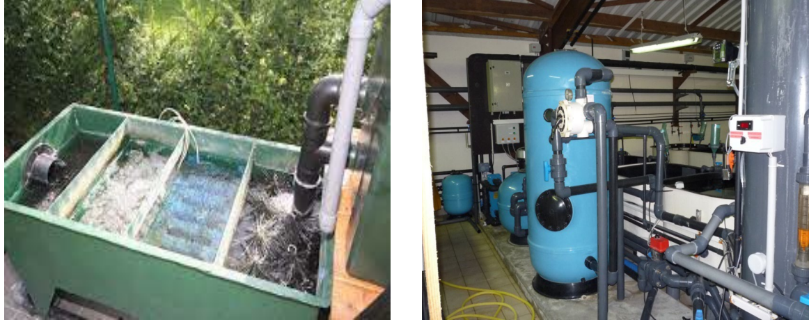
Figure 3. Système de filtration : biologique à gauche et mécanique à droite (Ifremer,2012)
