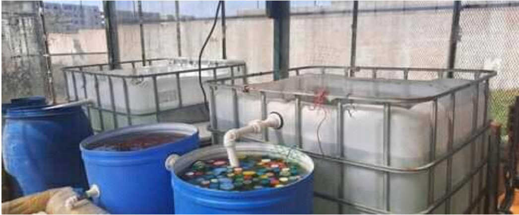
Figure 29 : Tuyauterie du bac à poissons aux filtres mécanique et biologique
