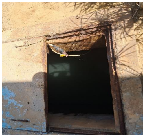
Figure 9: Bassin d'eau désinfectée (Photo Hendi Fathi 2026)
