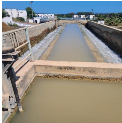
Figure 4: Cascade de l'aération (photo Hendi Fathi 2026)
