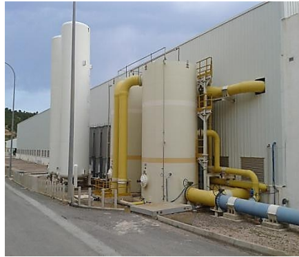
Figure 17: Les réservoirs de CO2 [59]
