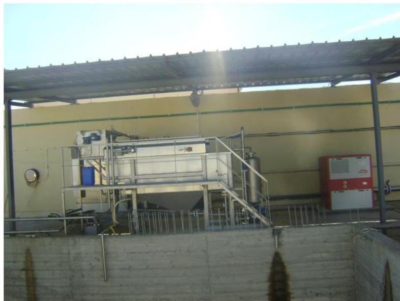
Figure 20 : Station de traitement des eaux usées ( https://www.facebook.com/profile.php?id=100011613579785 )
