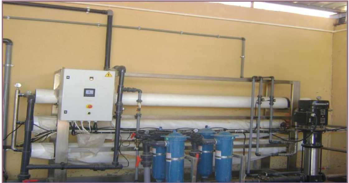
Figure 17 : Station de filtration d'eau usée ( https://www.facebook.com/profile.php?id=100011613579785 )
