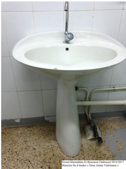
Figure N°13 : Robinet d'eau automatique
