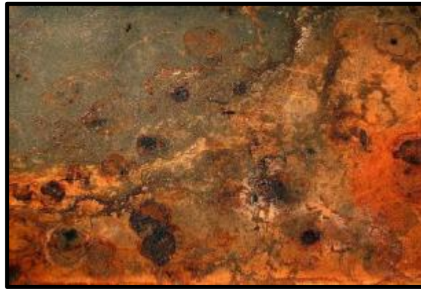
Figure I.1. Phénomène de corrosion
