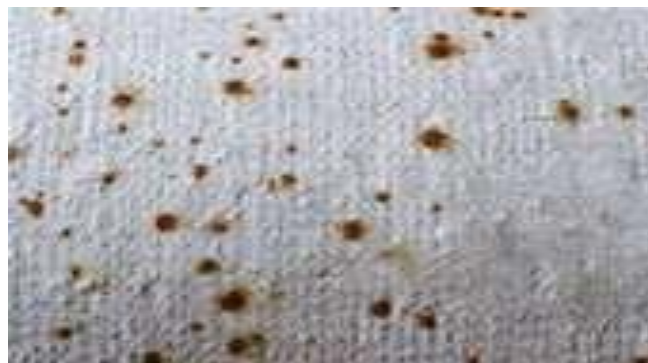
Figure N°17: Corrosion par piqûres d'un acier inoxydable
