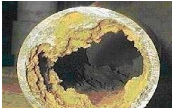
Figure N°20: La corrosion par crevasse [45].
