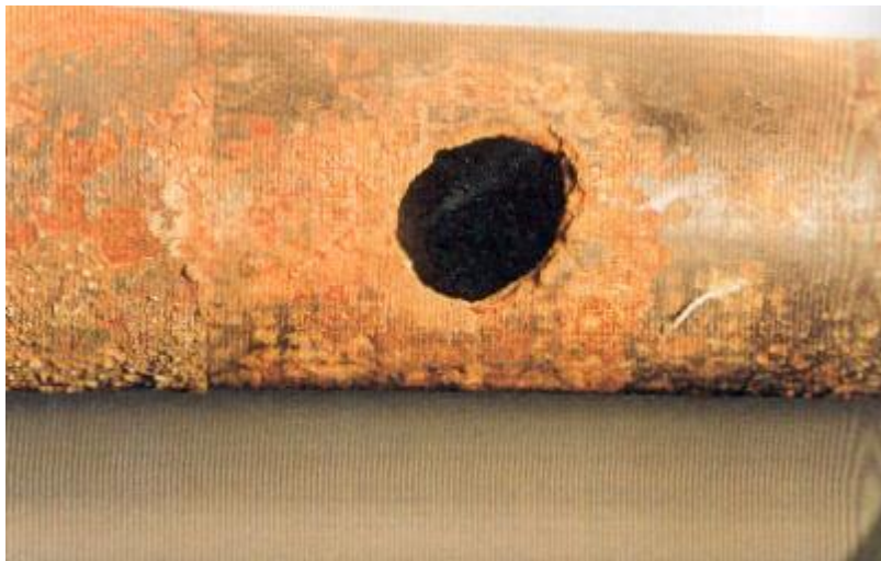
Figure N°11: Conduite de diamètre 80 mm ayant subi une corrosion externe localisée (courants vagabonds, hétérogénéité du sol, ...) [31].
