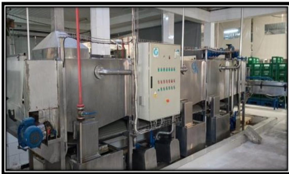
Figure 15 : Tunnel de refroidissement (Salhi Z., 2023)
