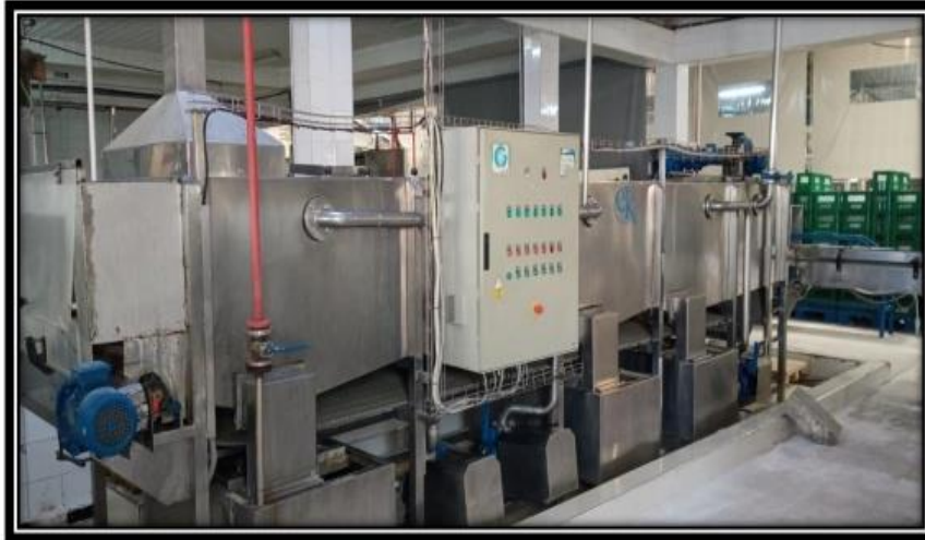
Figure 15. Tunnel de refroidissement (Boumaza S., 2026).
